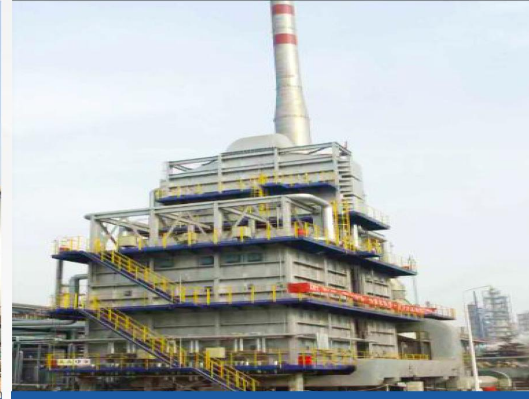
تكسير حمض الخليك Acetic acid cracking furnace
