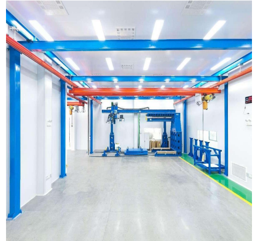
无尘车间 Dust free workshop
